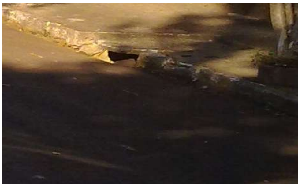
Figura 64: Boca de Lobo
