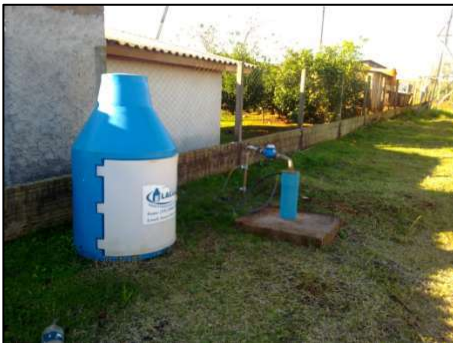
Figura 16: Poço no Bairro Navegantes (abastece a sede)
