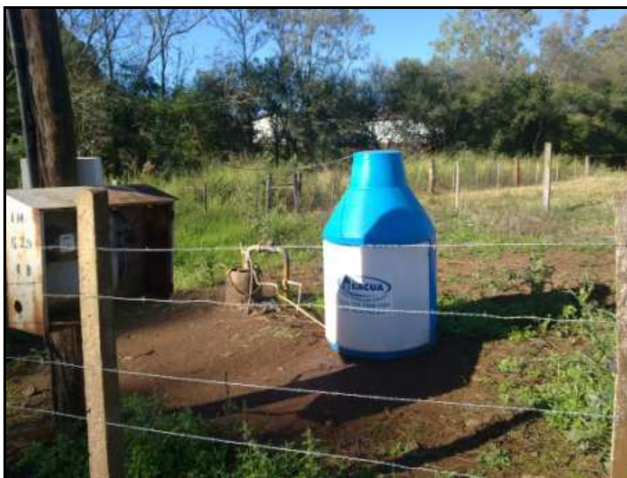
Figura 8: Poço da Linha Encantado – Abastecimento Sede
