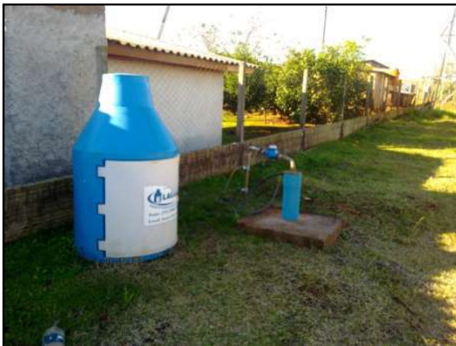
Figura 4: Poço no Bairro Navegantes (abastece a sede)
