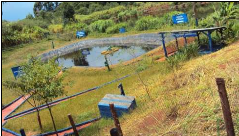
Figura 57: Lagoa aerada na ETE da empresa SIMPEX
