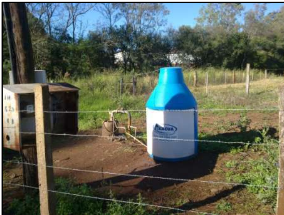
Figura 20: Poço da Linha Encantado – Abastecimento Sede
