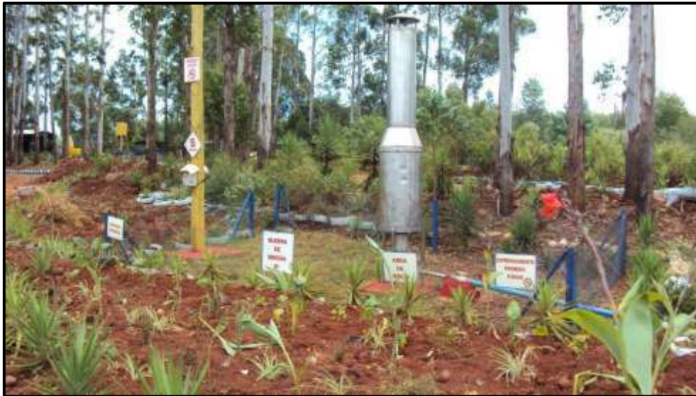
Figura 54: Sistema de queimadores de biogás.
