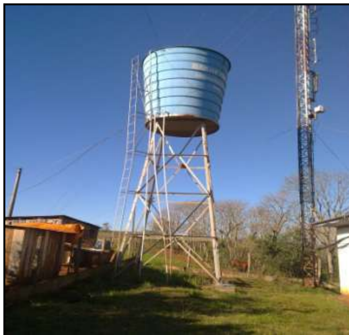
Figura 5: Reservatório no Bairro Navegantes
