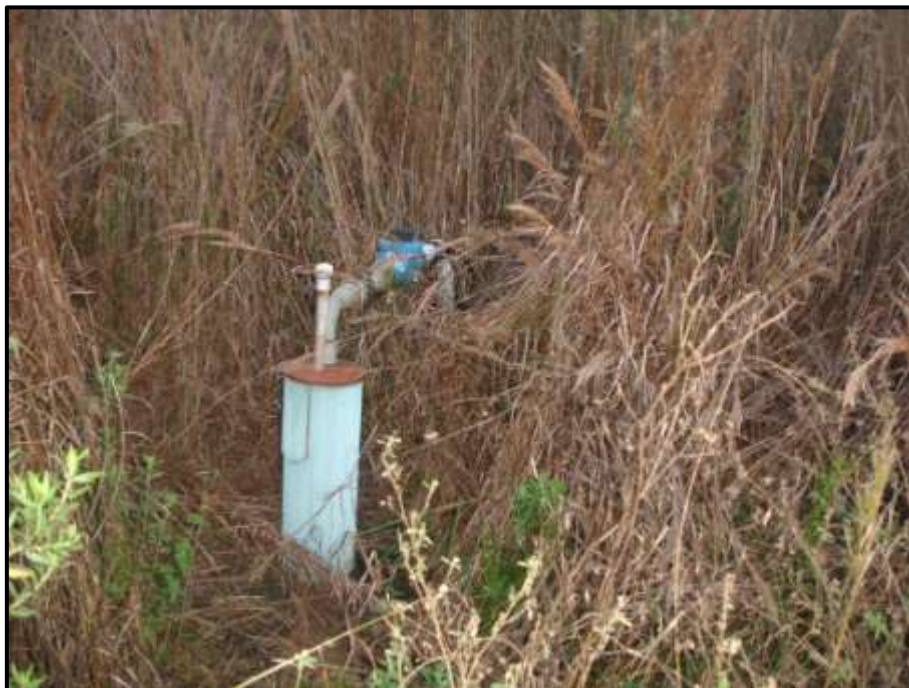
Figura 31: Poço Artesiano – Linha Carijó II
