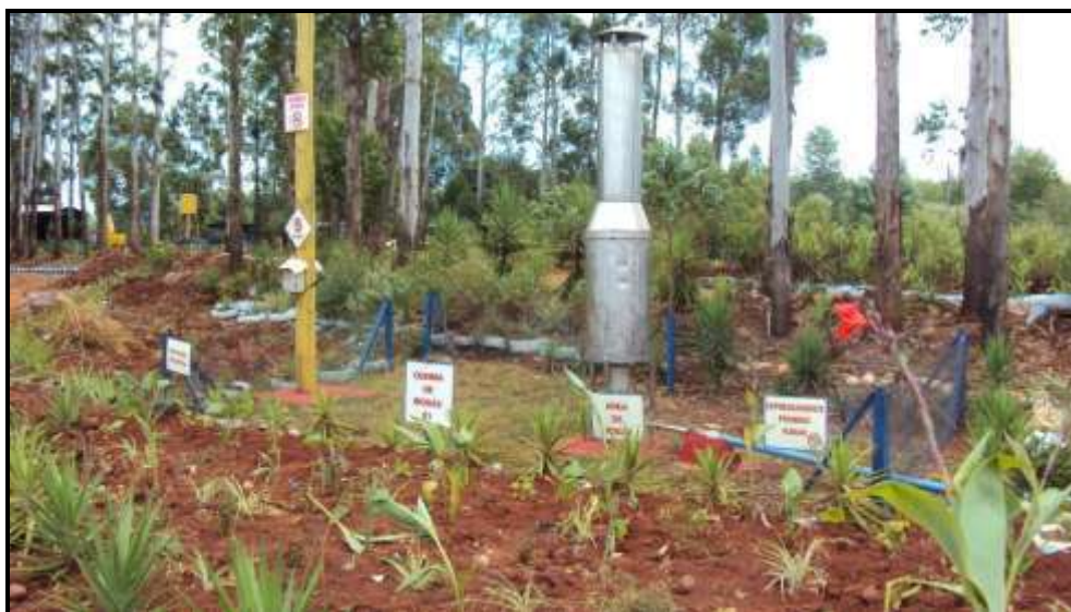
Figura 21: Sistema de queimadores de biogás.
