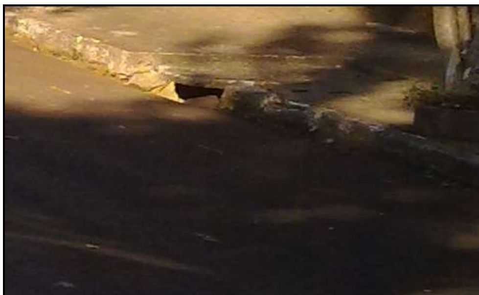
Figura 30: Boca de Lobo
