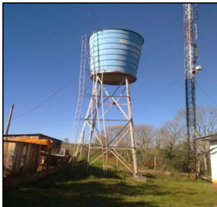
Figura 17: Reservatório no Bairro Navegantes
